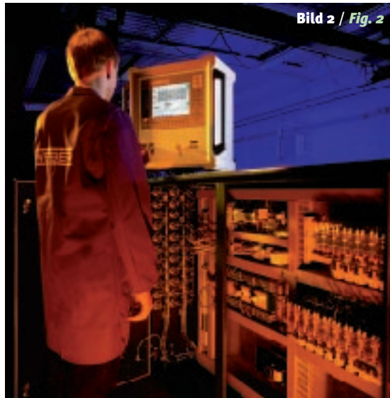
Bild 2: Bedienterminal IQT und die kompakt montierten Automatisierungskomponenten einer Weber Extrusionsanlage Fig. 2: IQT operating terminal and the closely mounted automation components of a Weber extrusion plant (Foto Weber, Kronach / PMA, Kassel)
