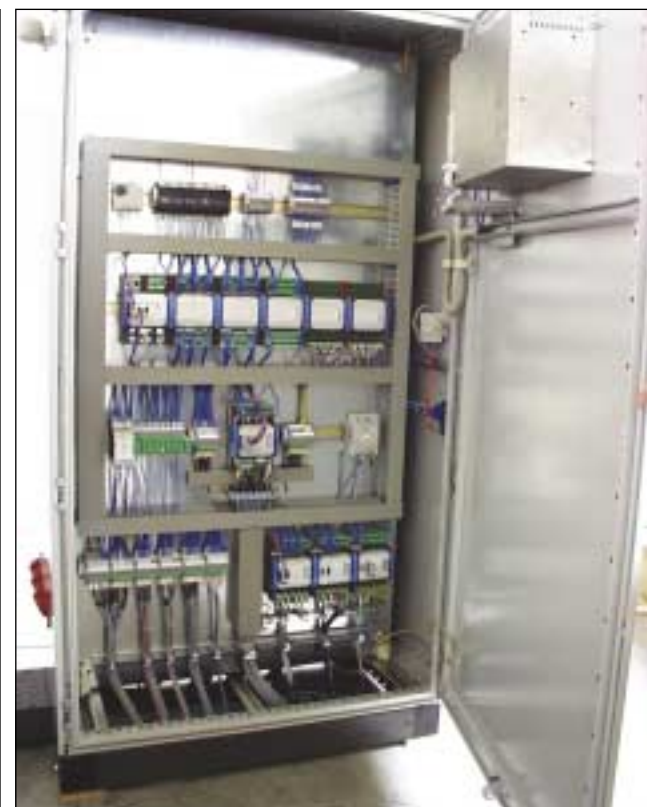
Im Schaltschrank-Zentrum befindet sich das Regelmodul DC150, darüber die Ablaufsteuerungsmodule, darunter die drei Multitemperaturregler KS800 und in der Tür der Industrie-PC
