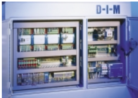
3: Der Schaltschrank einer Spritzgießmaschine zeigt, wie platzsparend die Installation einer Anlage bei einer direkten Verkabelung der intelligenten Module mit den Sensoren und Aktoren sein kann
