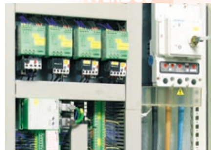
Die Kartonmaschinen werden mit INTERBUS ST-Modulen gesteuert
